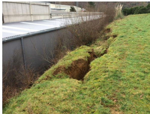
Imagen 9. Desmoronamiento del terreno en el talud entre el pabellón y el prado.
