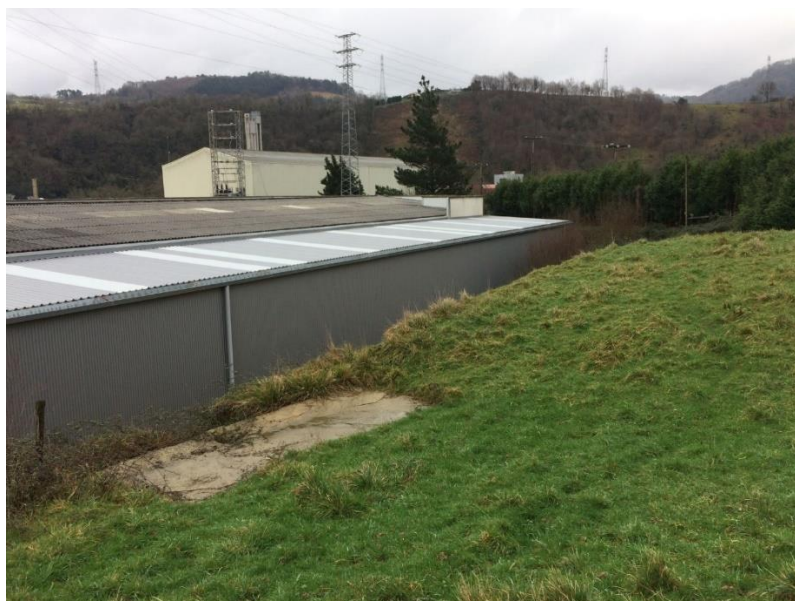
Imagen 1. En primer término, parte de la zona prevista para la ampliación y, a la izquierda, cubierta de la edificación que se pretende legalizar. El talud queda situado entre ambos.
